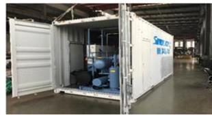
加氢站压缩机组
