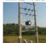
新建电力变压器
