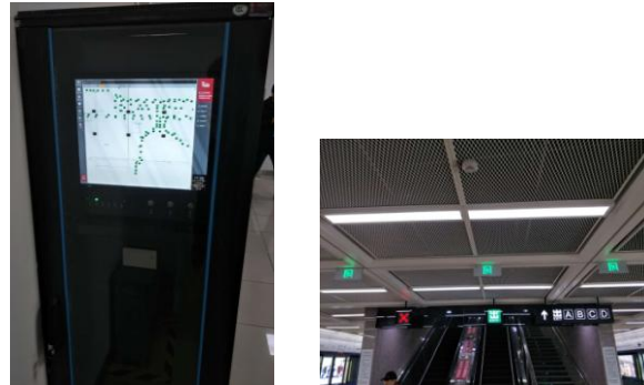
图 25: 应急照明和疏散指示系统应用现场
