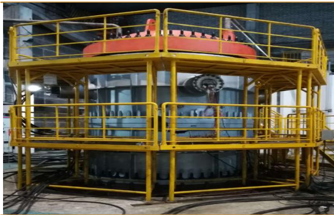
图 9：主氮风机顶部
