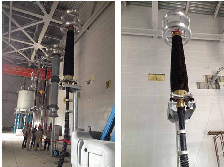
图 14: 公司产品在厦门 ±320kV 柔性直流输电工程
