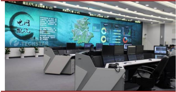
图 37: 电网智能控制中心
